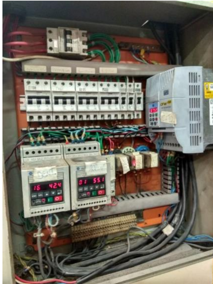
Figura 8: Parte interna do painel elétrico do fim da linha 05 Fonte: Autores
