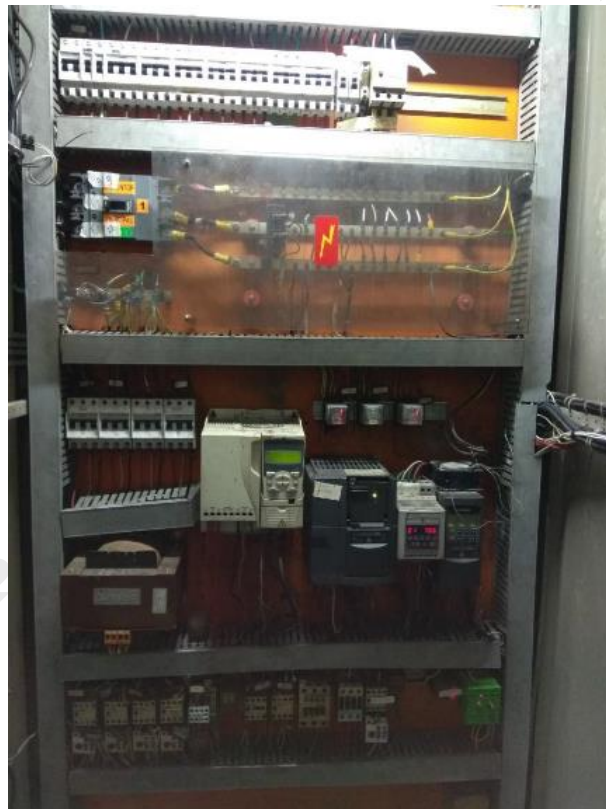
Figura 6: Painel elétrico que faz o controle do sistema Fonte: Autores
