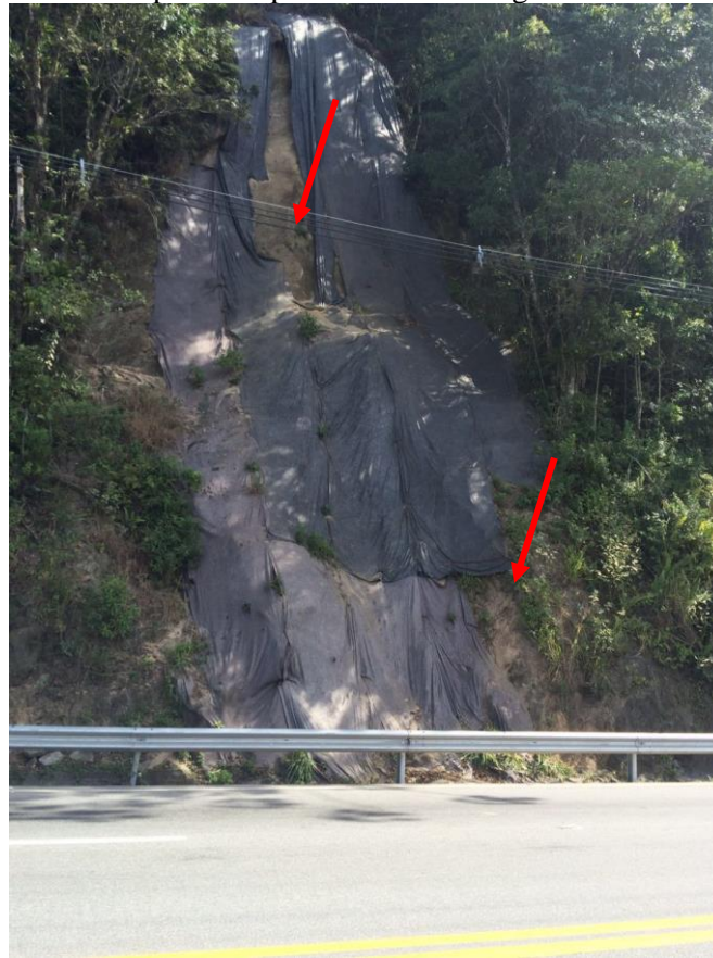
Figura 15- Aplicação de lonas plásticas para conter escorregamentos na encosta
