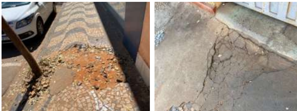
Figura 14: Calçada com buracos e irregularidades na rua Pernambuco
