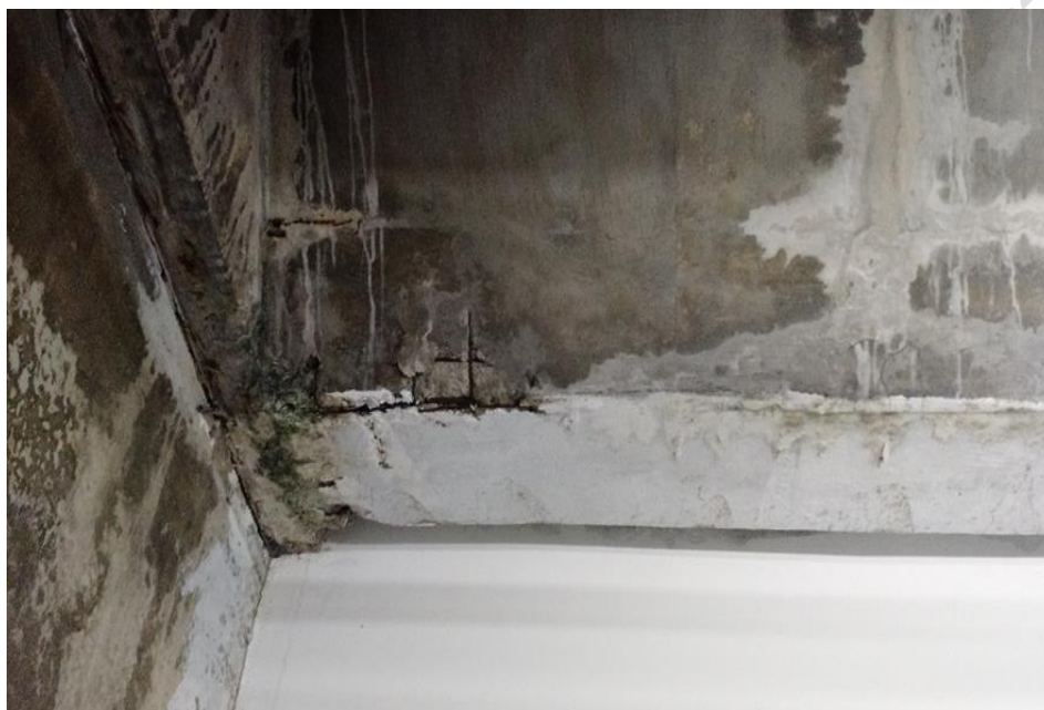
Figura 8 – Concreto desagregado com exposição da armadura e eflorescência
