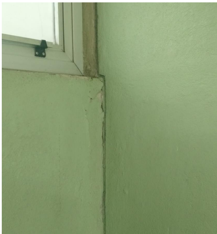
Figura 7 - Fissuras verticais no encontro entre paredes
