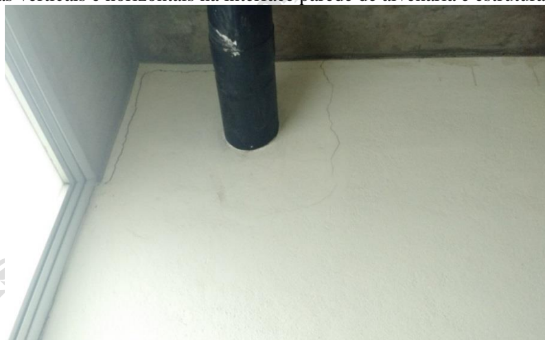
Figura 4 - Fissuras verticais e horizontais na interface parede de alvenaria e estrutura
